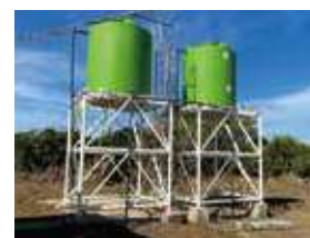
雨水貯水タンク
